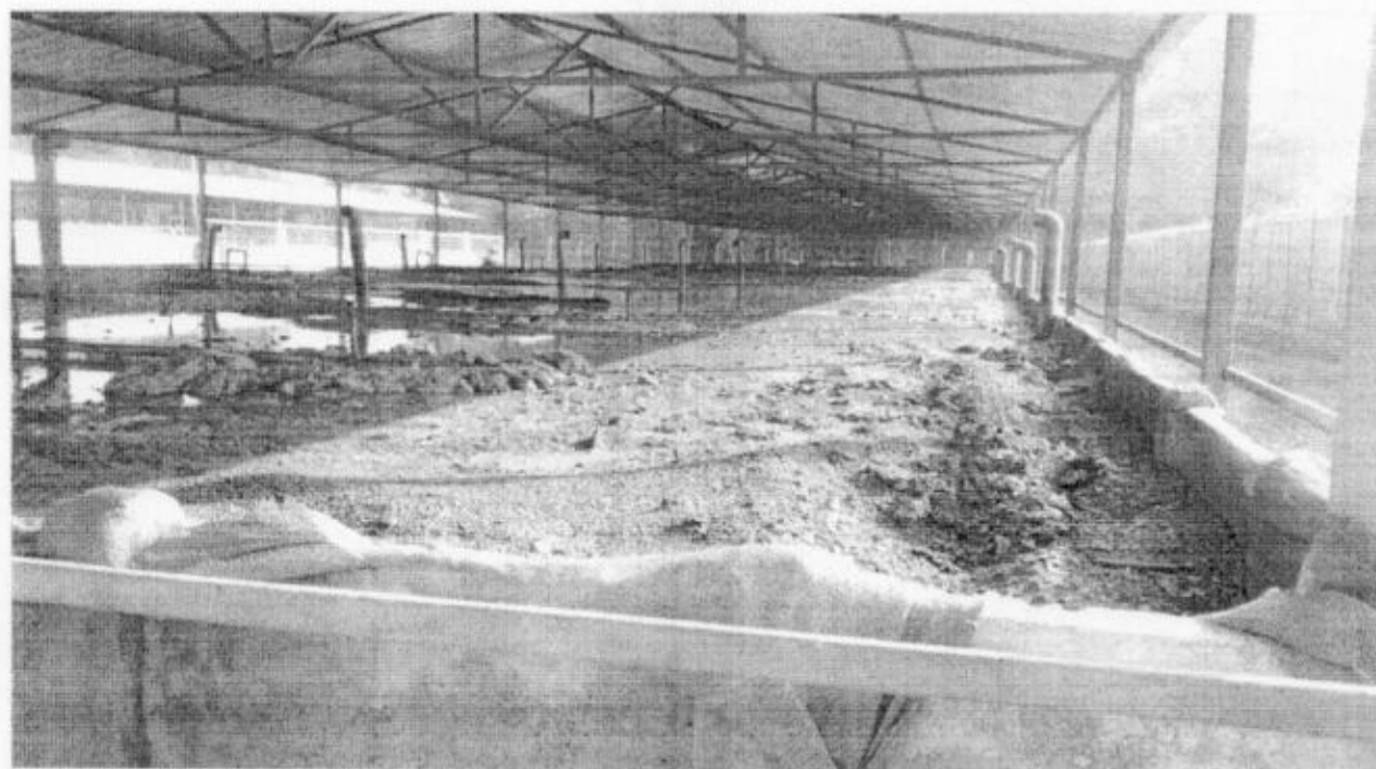
Fotografía 20: Se constata que el efluente del Sistema de Tratamiento de RILES, proveniente del Lombrifiltro (Sistema Tohá), tiene presencia de espuma y emite fuertes olores al ambiente, lo que indica que el tratamiento de RILES, no está siendo efectivo, toda vez que gran cantidad de las lombrices que se encuentran en la unidad biológica operativa, están muertas, dado que el PH del RIL, no se ajusta al recomendado para que éstas, traten las aguas eficientemente.
