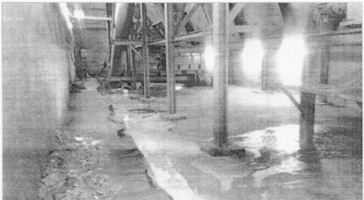
Fotografía 12: En galpón de ingreso de la materia prima, se aprecia bajo las dos tolvas de recepción, derrame de residuos líquidos y sólidos al piso, producto de filtración, generando presencia de malos olores
