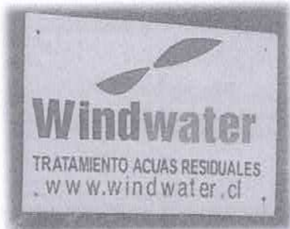
Detalle señalética instalada en la caseta de la PTAS de Parinacota.
