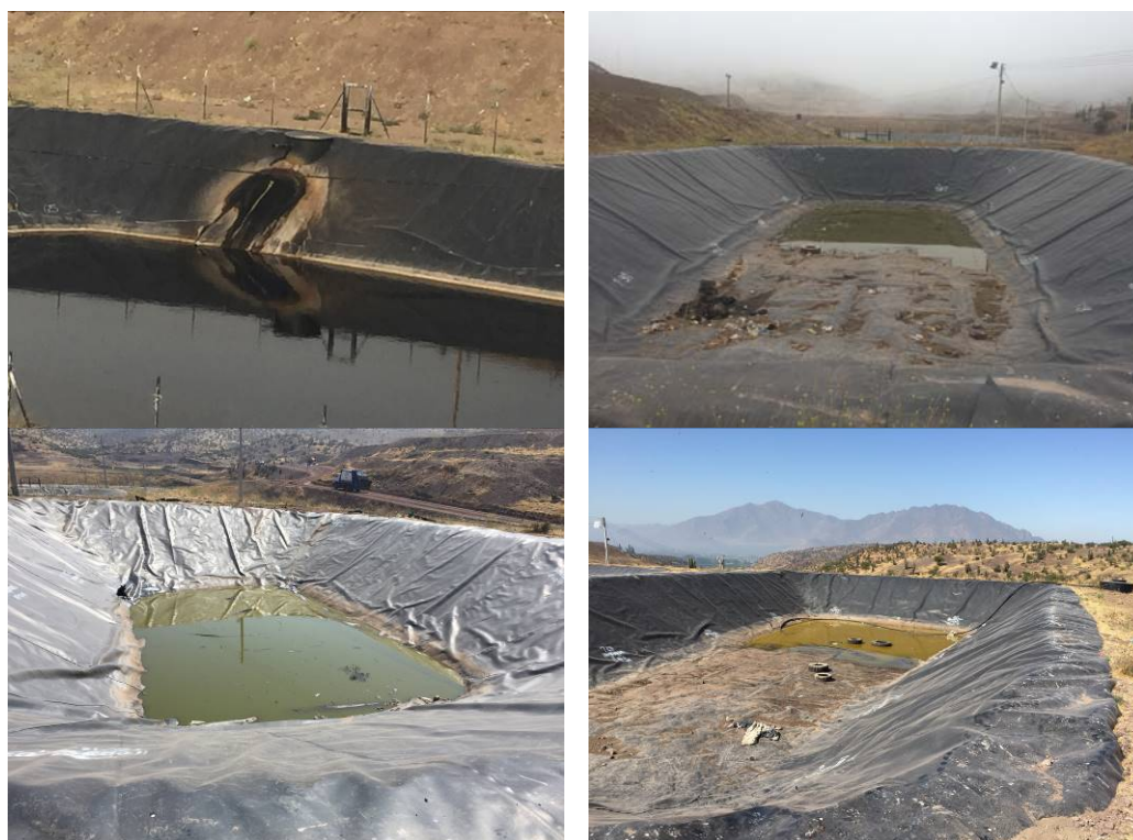
Figura 8 Laguna de almacenamiento y piscinas de sistema de tratamiento
