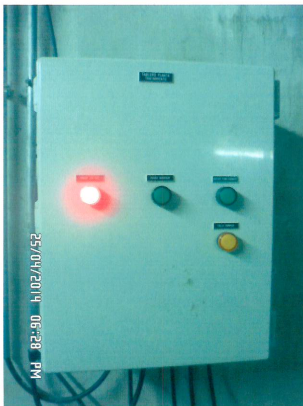
FIGURA 8.1: Panel de control de planta de tratamiento VA 0,5 que evidencia funcionamiento de esta.
