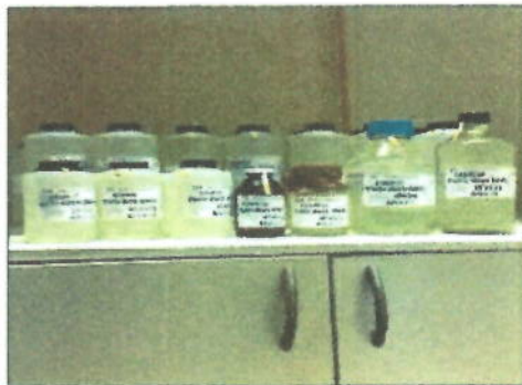
Fotografía 2: Set de Batería
