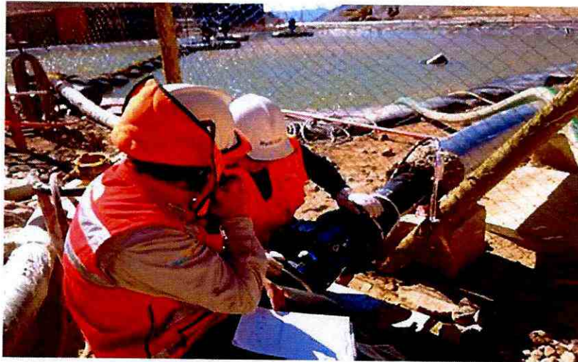
Figura 1: Pruebas de las Bombas de Impulsión
