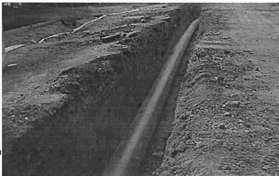
c) Tubería PE 200. Cuenta con una tensión
