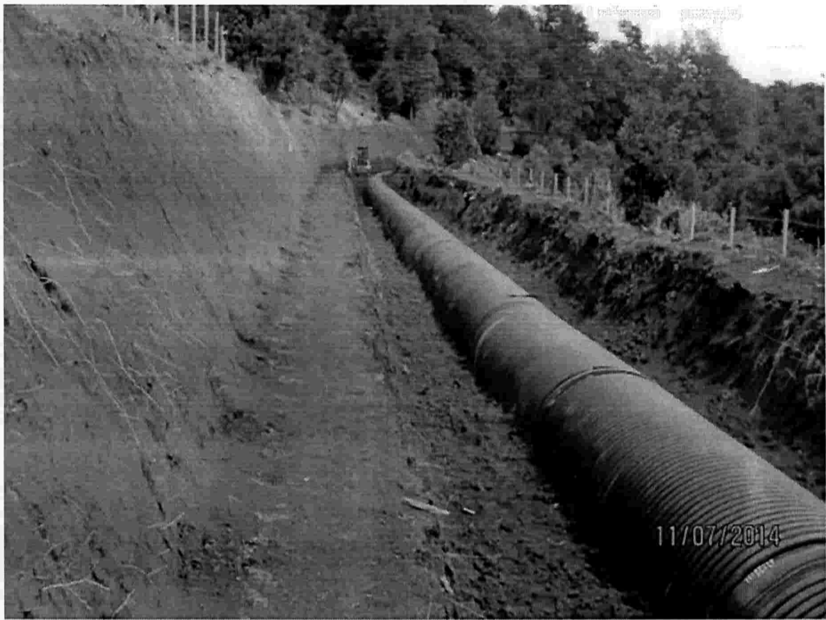
DUCTO CON EPISODIO DE FRACTURA
