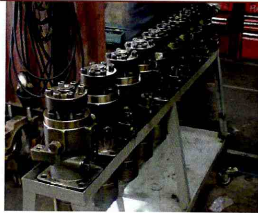
Mantenimiento preventiva Bombas Inyectoras
