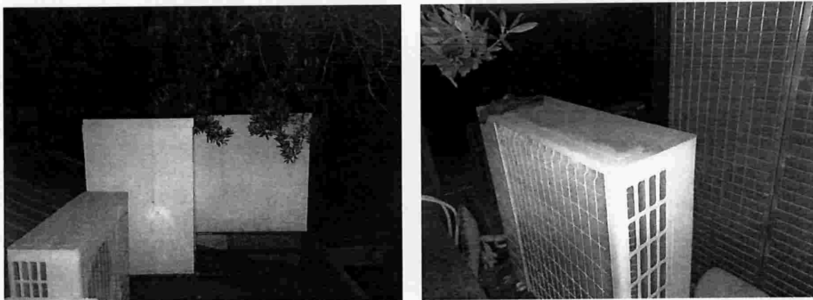
Equipo de climatización.
