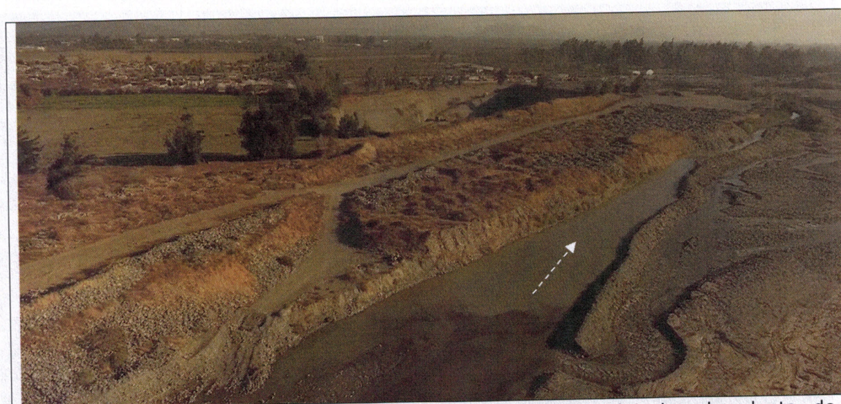
Imagen 5: obras de conducción de escurrimiento hacia interior de planta de procesamiento de áridos
