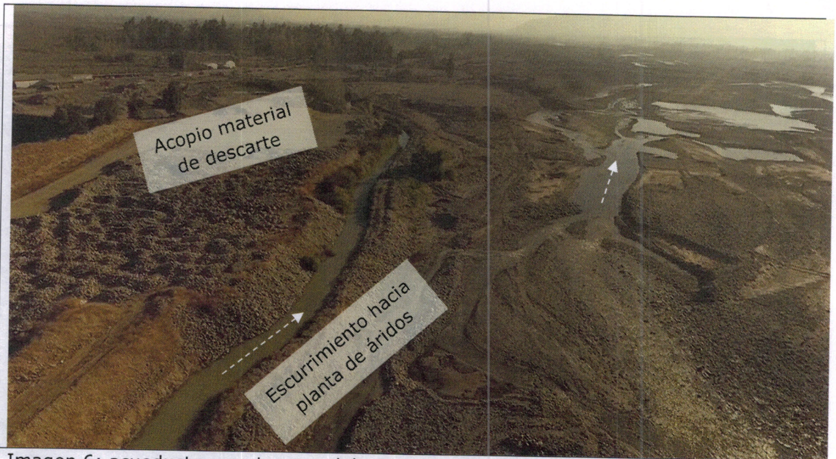
Imagen 6: acueducto para ingreso del escurrimiento hacia la planta de áridos
