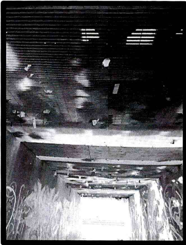
Parte superior del paso multipropósito, en mal estado, sin el recubrimiento necesario y con basura.
