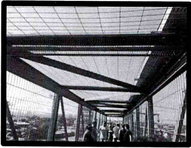
Parte superior de la pasarela, sin protección en lo que corresponde a la techumbre.
