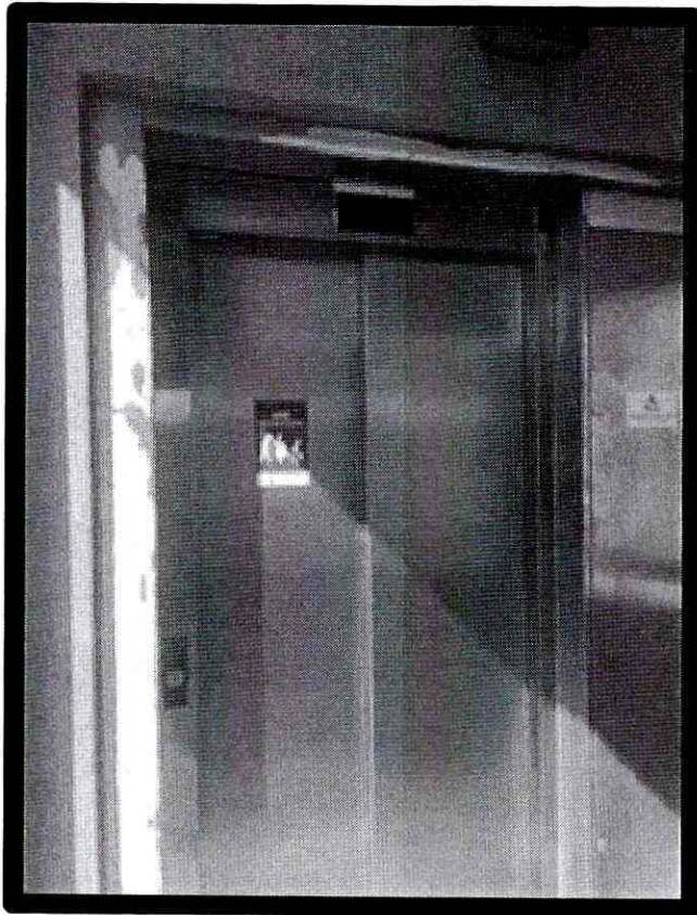
Ascensor lado oriente de la estación, en malas condiciones de diseño.
