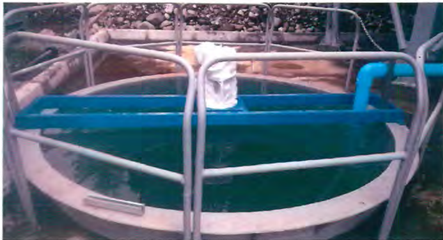
Figura N° 5: Estanque Acondicionador de Lodos
