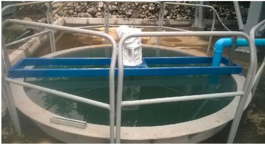
Figura N° 5. Estanque Acondicionador de Lodos
