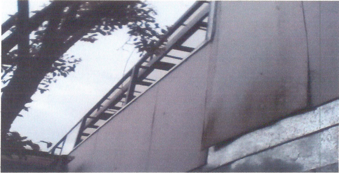
Ilustración 10: Muralla del local comercial, sin vidrios, solo marcos de acero. Imagen tomada desde propiedad familia Garfias.
