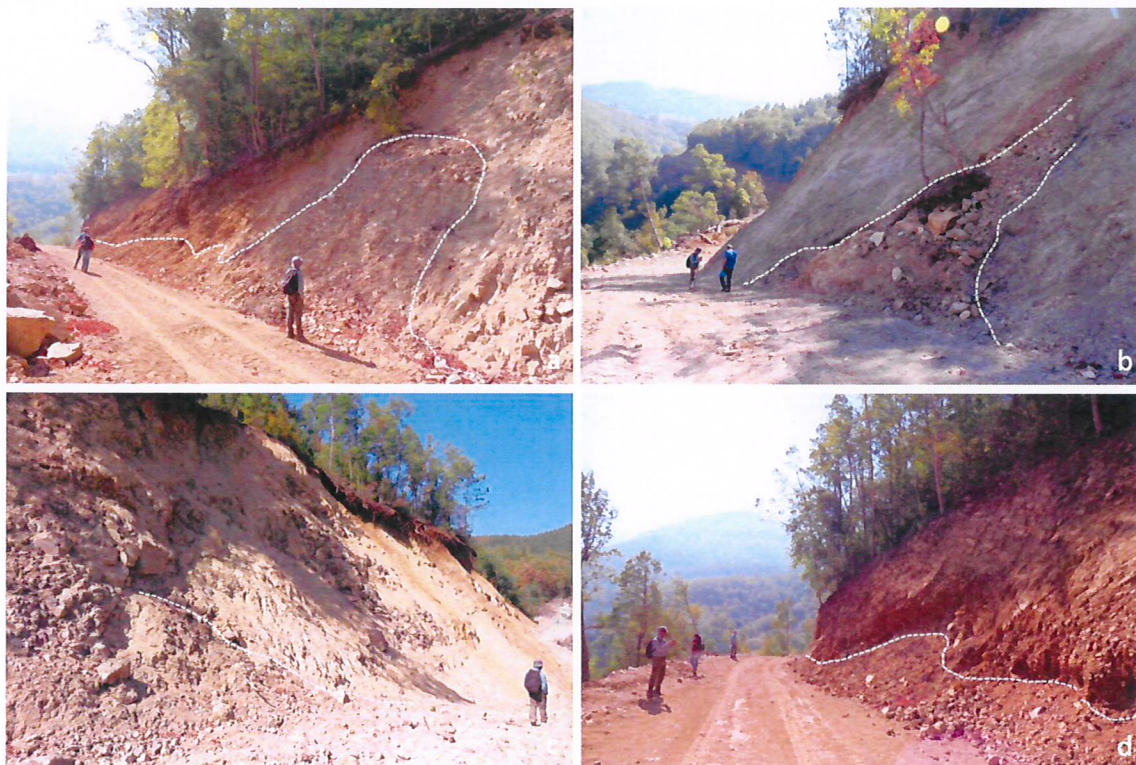
Figura 8: Imágenes de varias remociones en masa o sectores susceptibles a generarlas, a lo largo de los caminos del sector.
