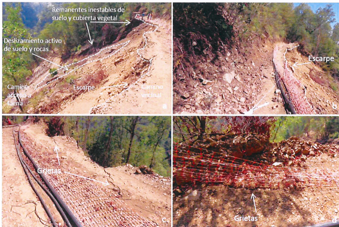
Figura 5: a) y b) Escarpe de remoción en masa que destruyó totalidad de tramo del camino vecinal. Imágenes de los depósitos de deslizamiento de suelo y rocas se observan en vista desde camino de acceso a faena, se detallan en la siguiente figura. c) y d) Grietas extensionales en bordes del escarpe evidenciando alta inestabilidad en camino vecinal. Sector vulnerable a generar nuevos deslizamientos.
