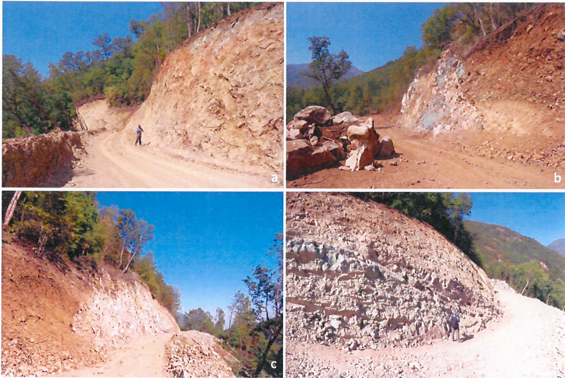
Figura 15: Imágenes de taludes subverticales en camino
