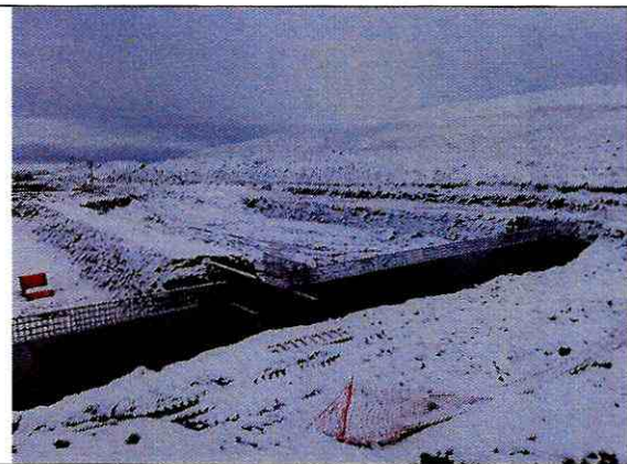
PISCINA DECANTACION 2 DE CI2
