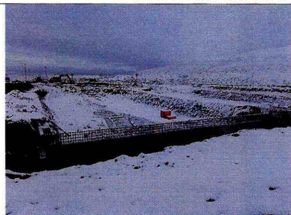
PISCINAS DECANTACION CI2
