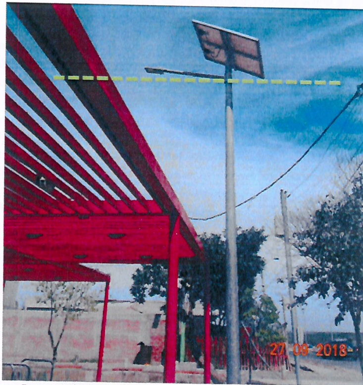
Imagen 2. Luminaria con panel fotovoltaico en Plaza González Sierra.
