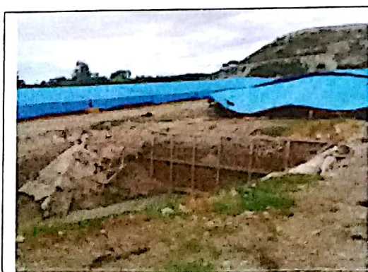
Fotografía 5: Zanja 4 con techo en mal estado.
