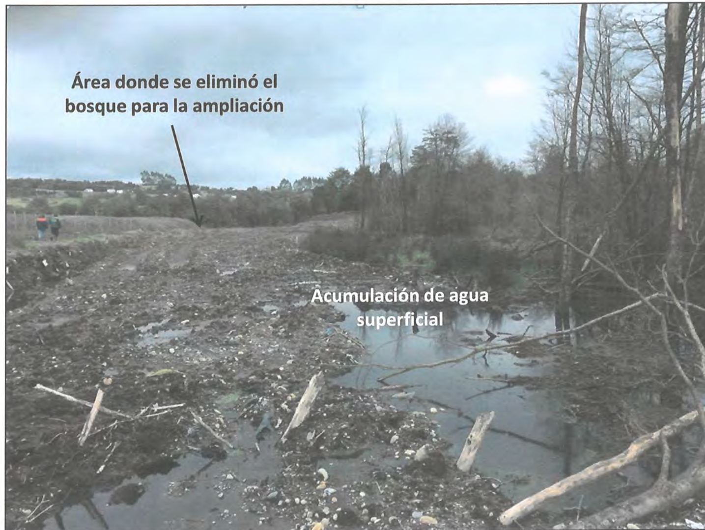
Imagen 7: Se aprecia área de bosque muerto en pie producto del anegamiento generado por la remoción de material para la ampliación de vertedero y la posterior obstrucción del curso de agua natural.
