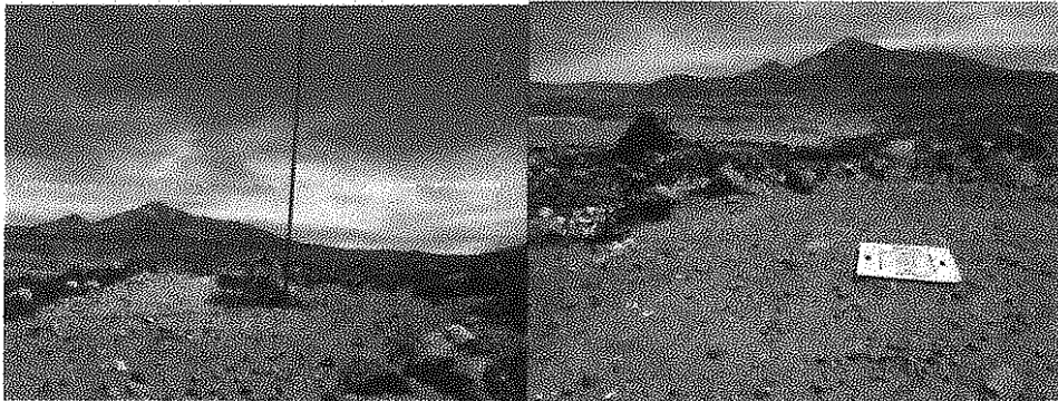
Fotos 2 y 3. Pararrayos ubicado en el hábitat de las vizcachas y en el trayecto del soterramiento de cables, la tapa de cemento indica "Alta tensión, peligro de muerte".
