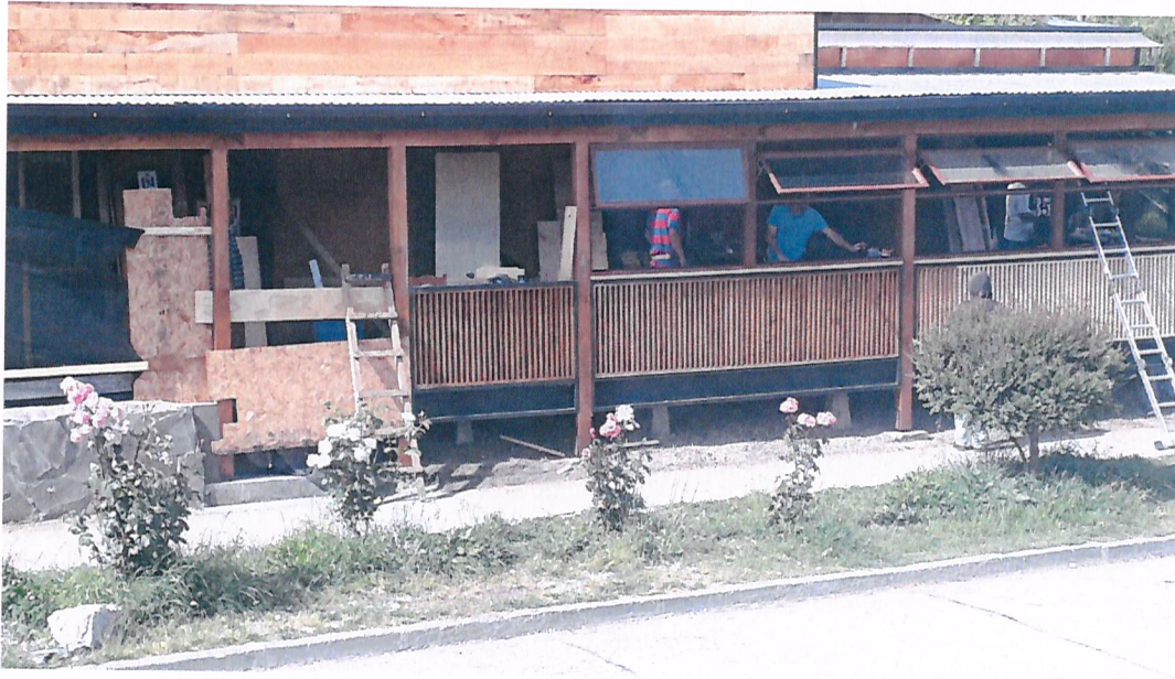
Ventanas no son termopanel, se abren en la parte superior, no ayudando a mitigar el ruido
