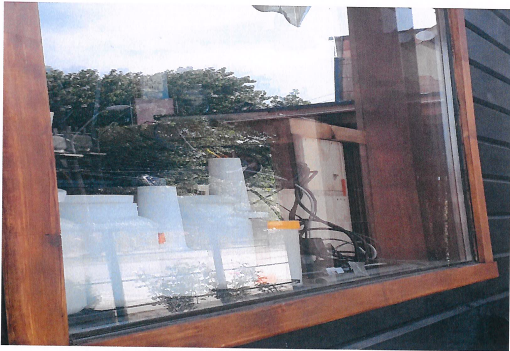
Ventana, no es termopanel, no corresponde a lo informado
