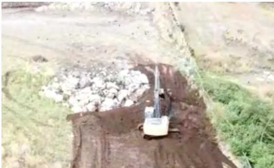
Fig. 14. Enterramiento de maxisacos con basura industrial al interior del vertedero municipal. Fotografía tomada con dron el 05/02/2020.
