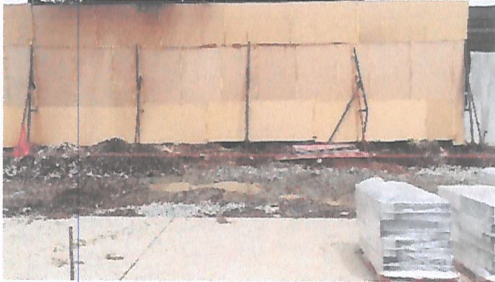
Figura 2. Fotografía pantalla acústica.
