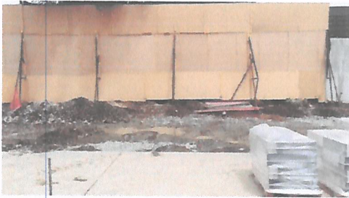
Figura 1. Fotografía pantalla acústica.
