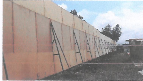
Figura 3. Fotografía pantalla acústica.
