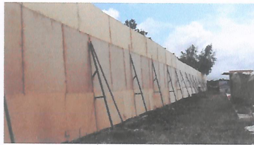
Figura 2. Fotografía pantalla acústica.
