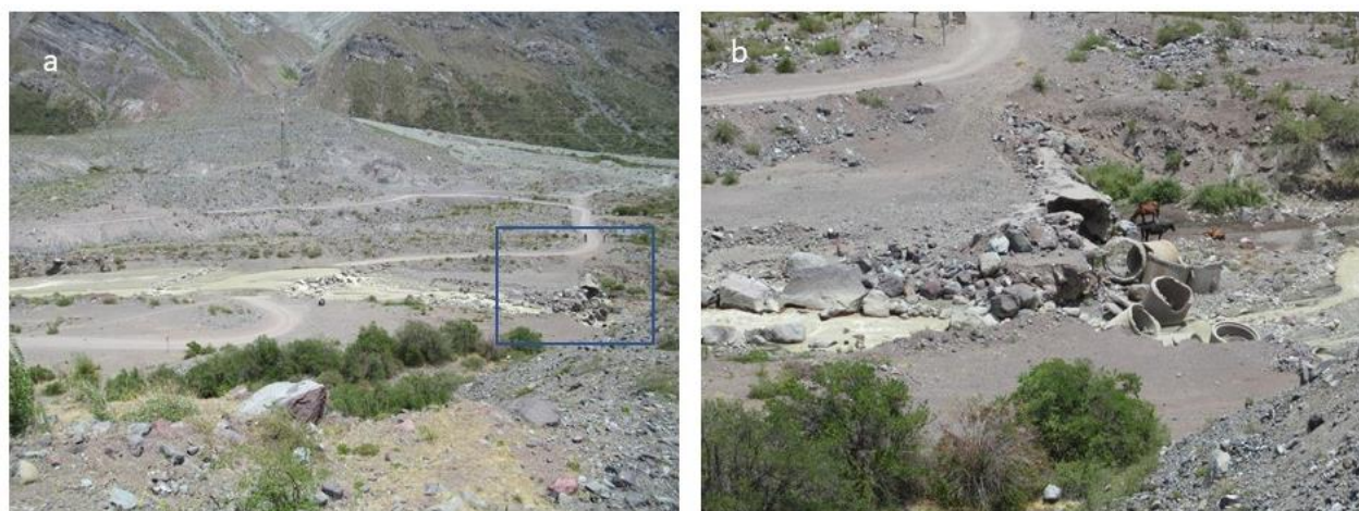
Figura 3 a) Vision general del area del Baden b) detalle del tramo con restos del Baden.
