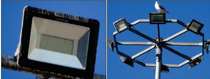
Fuente: Informe de Fiscalización DFZ-2019-2121-IV-NE, Fotografías 1 y 3.
