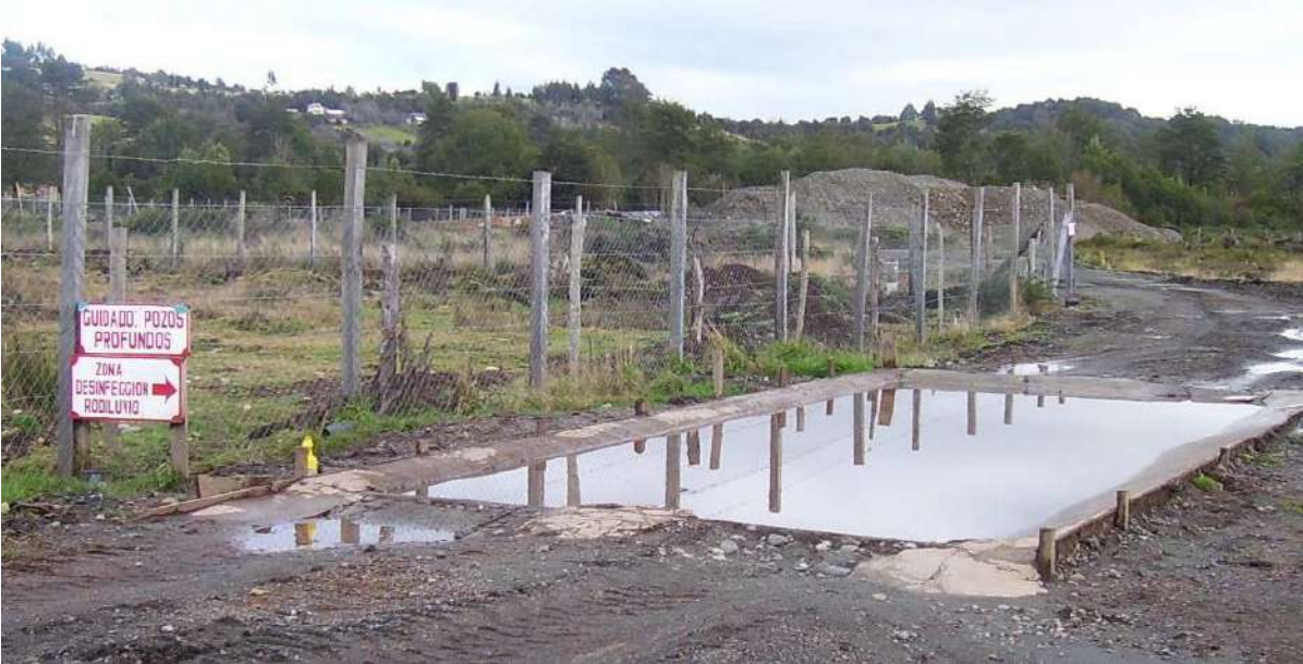
Fig. 5. Loza para el lavado de camiones con sistema de recolección de aguas.
