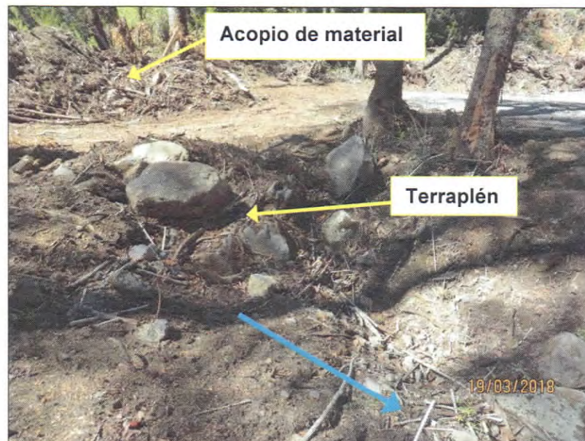
Imagen 2. Terraplén construido y acopio de tierra, ramas y rocas sobre brazo del cauce natural.
