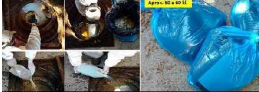
Imagen N°2 – Revisión Cámara desgrasadora (grasa solida).
