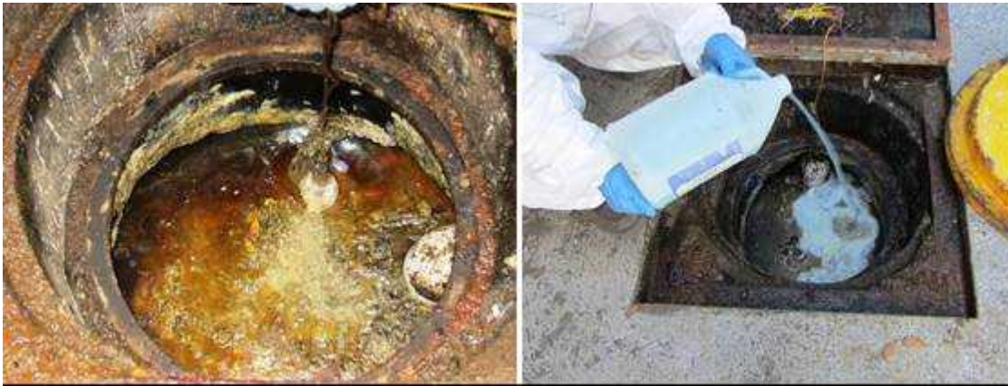
Imagen N°2 – Revisión Cámara desgrasadora (grasa solida).
