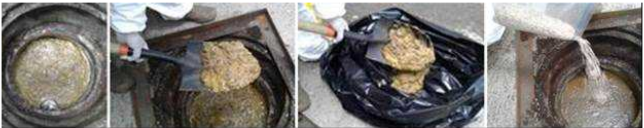
Imagen N°2 – Retiro de grasa solida de desgrasador de cocina Hotel.
