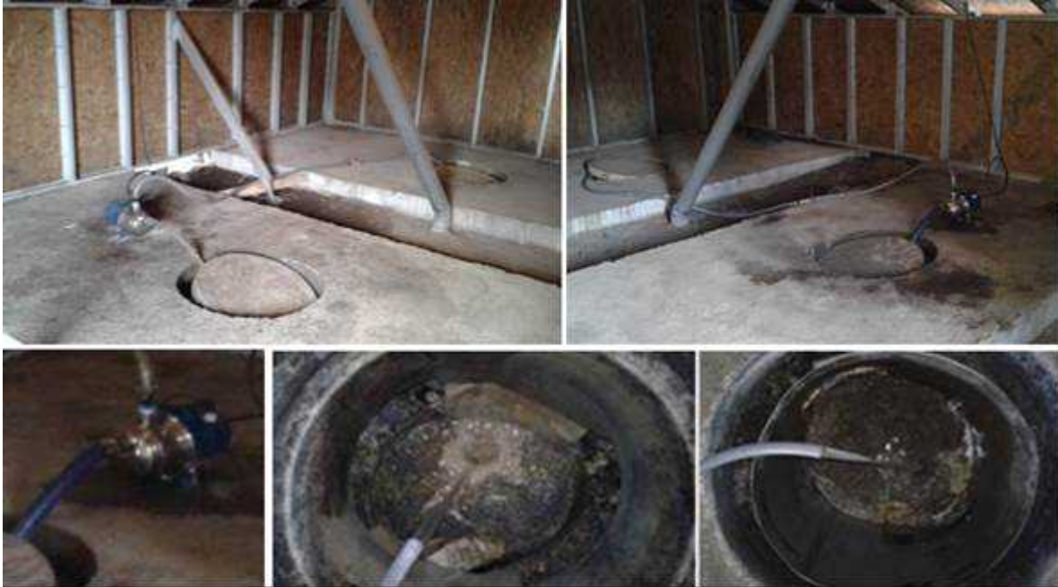
Imagen N°7 – Recirculación desde reactor a cámaras decantadoras
