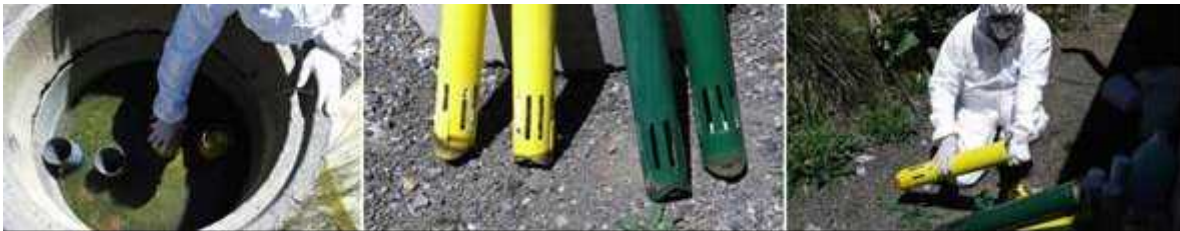
Imagen N°6 – Relleno Dispensadores de tabletas cloradoras y de cloradoras.
