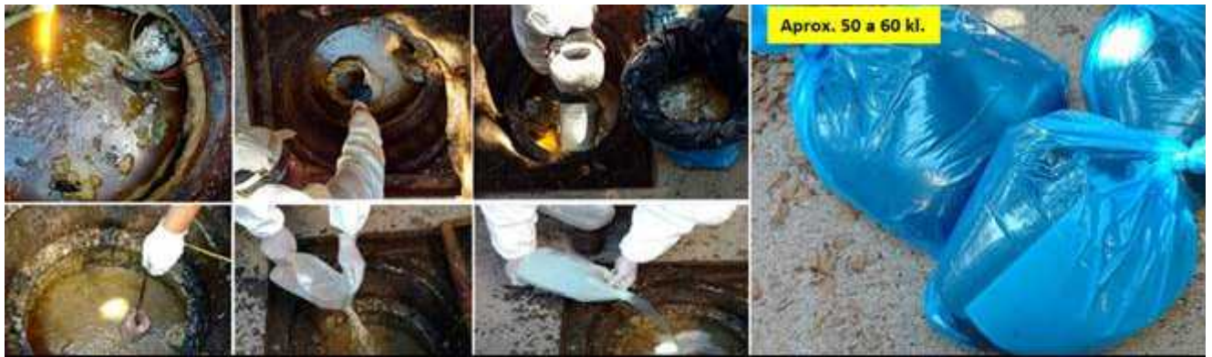
Imagen N°2 – Revisión Cámara desgrasadora (grasa solida).
