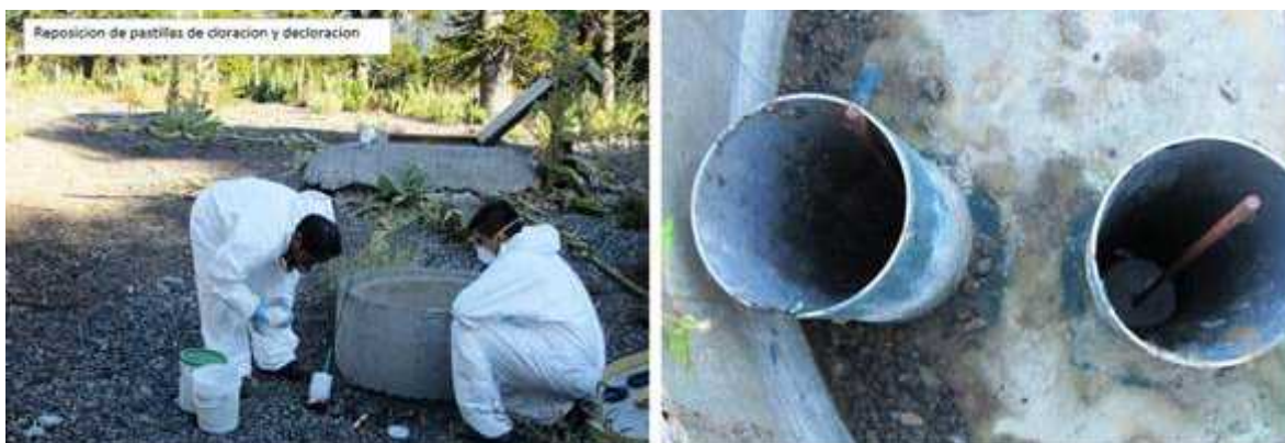
Imagen N°6 – Relleno Dispensadores de tabletas cloradoras y de cloradoras.
