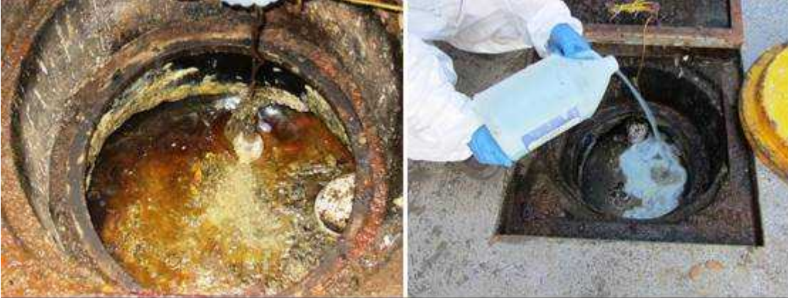
Imagen N°2 – Revisión Cámara desgrasadora (grasa solida).
