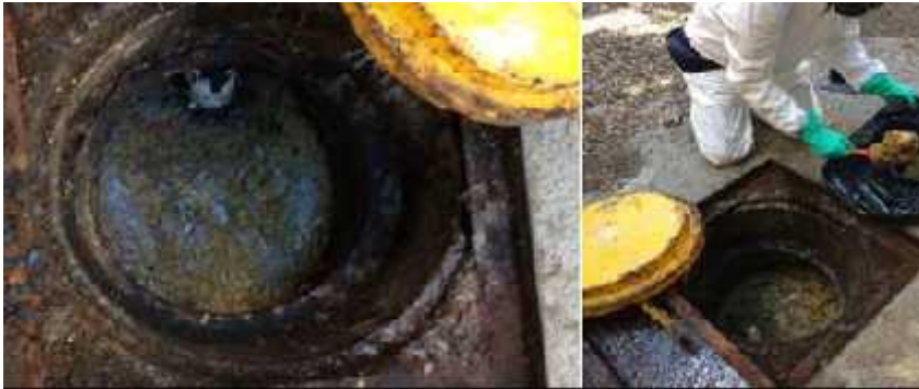
Imagen N°2 – Revisión Cámara desgrasadora (grasa solidificada).
