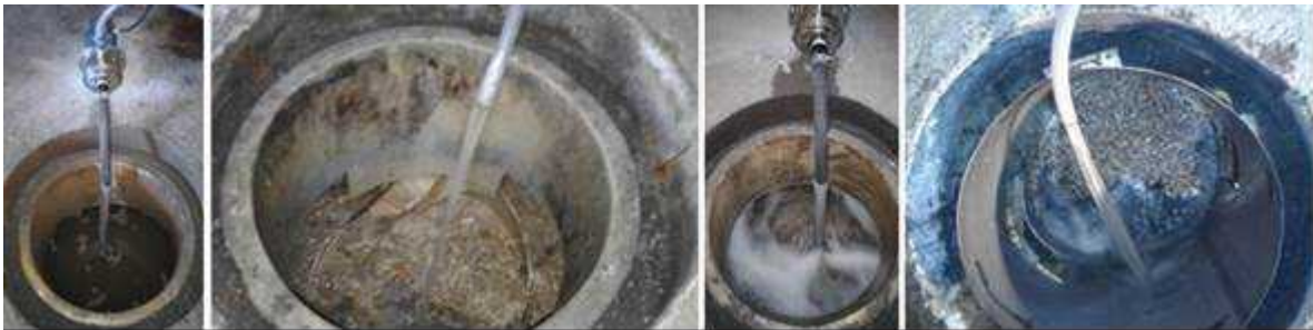
Imagen N°7 – Recirculación desde reactor a cámaras decantadoras
