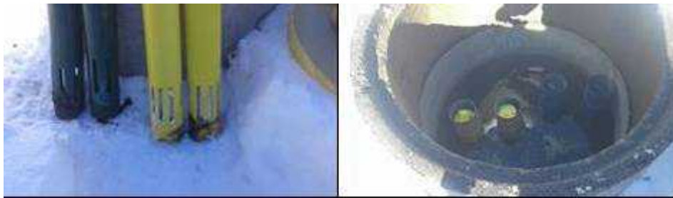
Imagen N°6 – Relleno Dispensadores de tabletas cloradoras y decloradoras.
