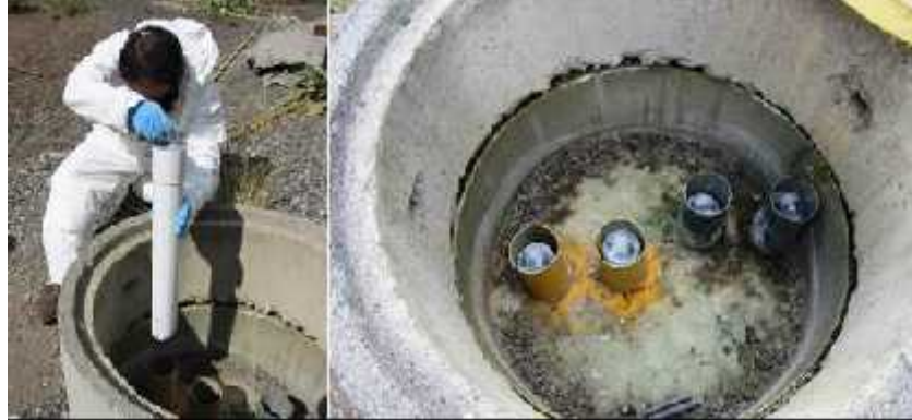
Imagen N°6 – Relleno Dispensadores de tabletas cloradoras y decloradoras.
