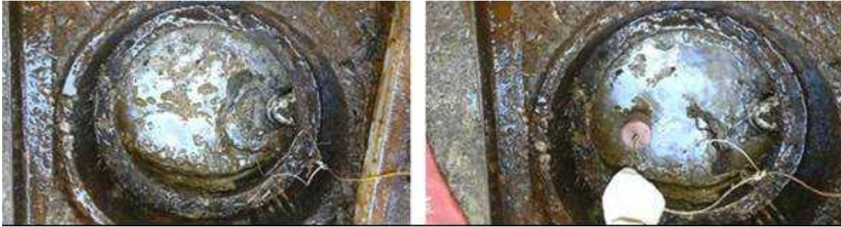
Imagen N°2 – Revisión Cámara desgrasadora (grasa solida).
