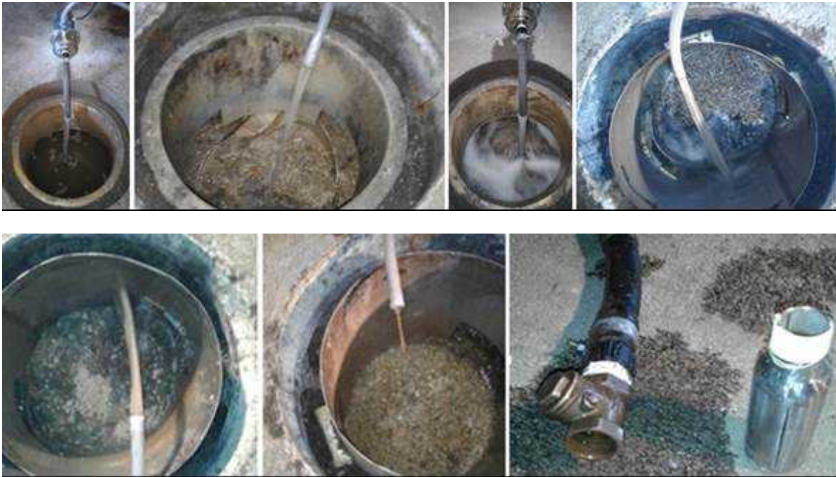
Imagen N°7 – Recirculación desde reactor a cámaras decantadoras y se instala filtro de succión.
