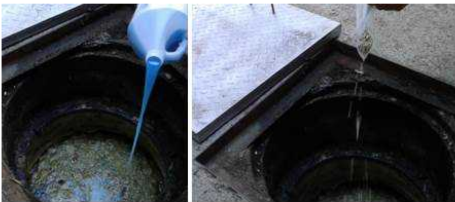
Imagen N°2 – Revisión Cámara desgrasadora (grasa solida).
