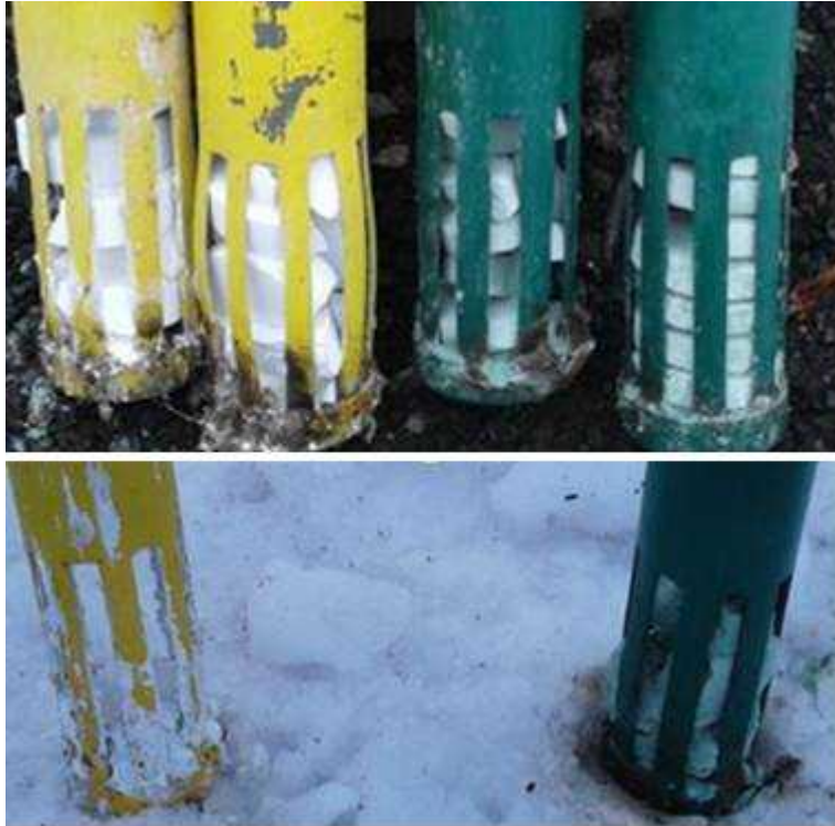
Imagen N°6 – Relleno Dispensadores de tabletas cloradoras y de cloradoras
