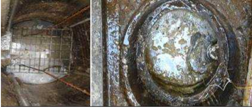
Imagen N°2 – Revisión Cámara desgrasadora (grasa solida).
