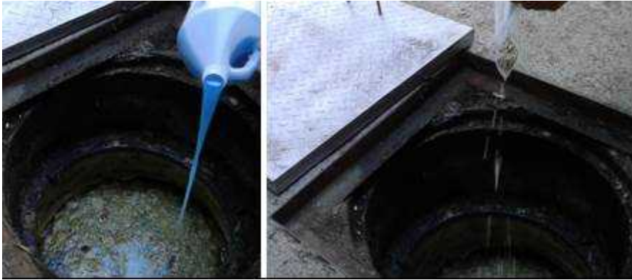
Imagen N°2 – Revisión Cámara desgrasadora (grasa solida).
