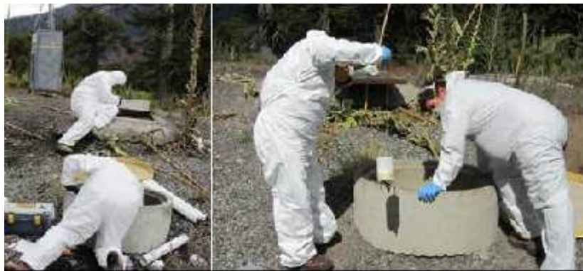
Imagen N°6 – Relleno Dispensadores de tabletas cloradoras y decloradoras.
