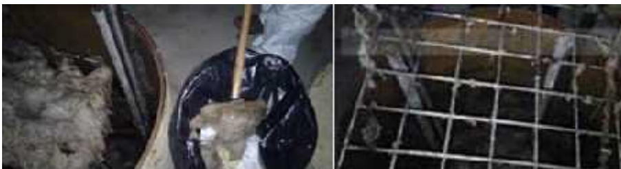
Imagen N°2 – Retiro de grasa solida de desgrasador de cocina Hotel.
