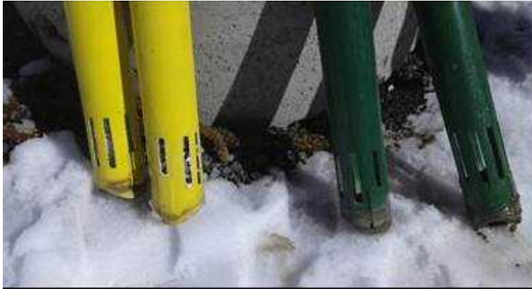
Imagen N°6 – Relleno Dispensadores de tabletas cloradoras y de cloradoras.
