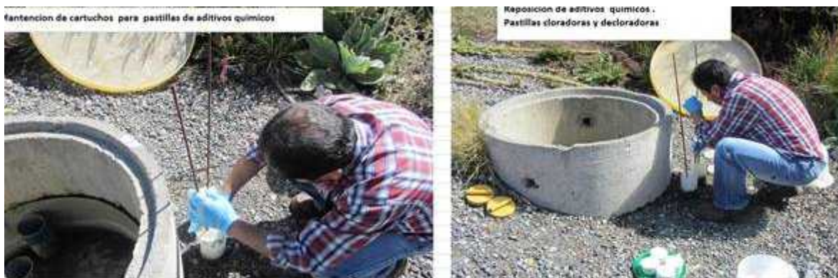
Imagen N°6 – Relleno Dispensadores de tabletas cloradoras y de cloración.
