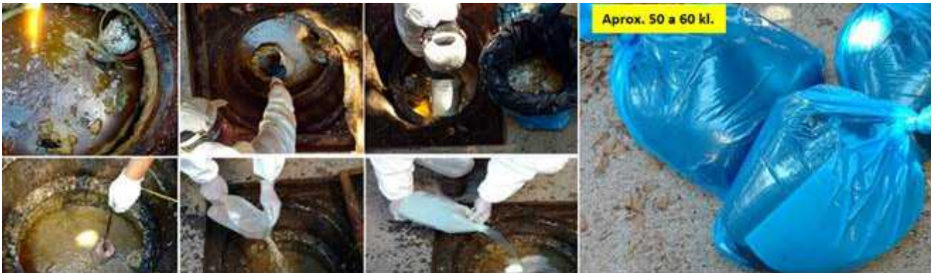
Imagen N°2 – Revisión Cámara desgrasadora ( grasa solida).
