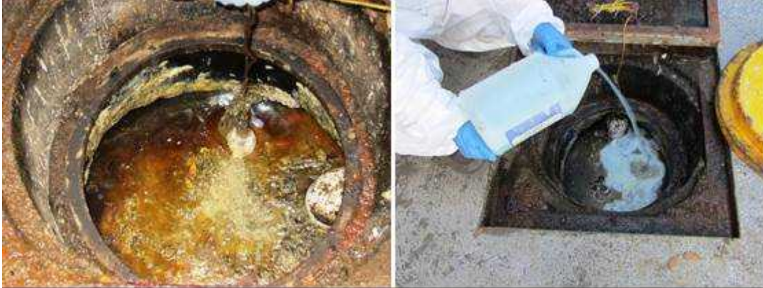
Imagen N°2 – Revisión Cámara desgrasadora (grasa solida).
