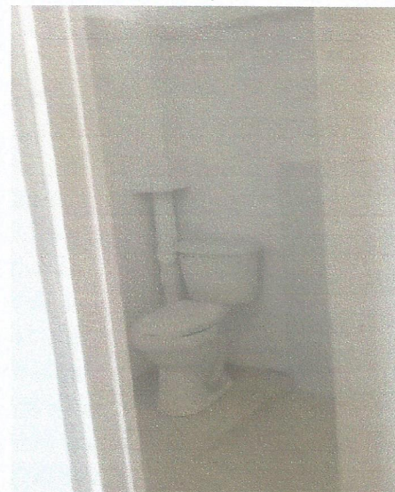
Imagen 2: baño de discapacitados. Se ventilación de alcantarillado a la vista.
