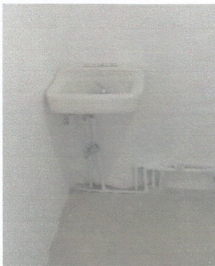
Imagen 1: baño de discapacitados. Se aprecian cañerías de agua potable y alcantarillado a la vista.
