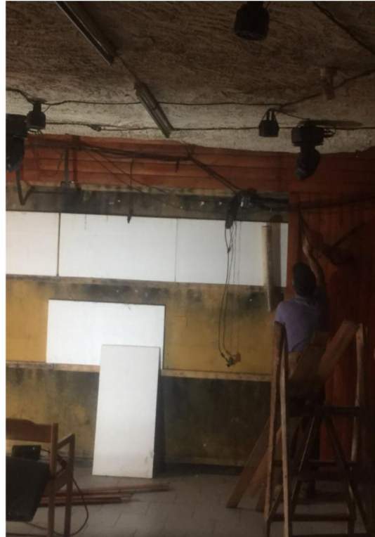
Imagen enviada por Javier pinto. Lunes 17 de febrero DE 2020. Donde se demuestra que NO TENIA AISLANTE.
