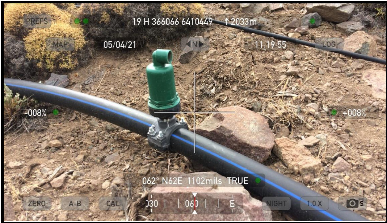
Sistema de riego en buen estado.
