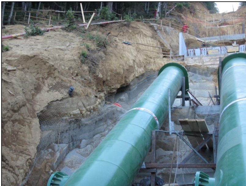
Fotografía 5-1: Excavación de ladera en materiales no consolidados compuesto de suelos de origen volcánico.
