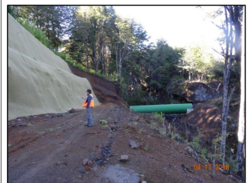
Imagen N° 3: Mismo sector de la imagen N° 2, donde se aprecia fuerte pendiente del talud sobre la tubería (localizada bajo el funcionario de la imagen).
