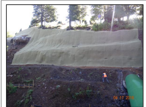
Imagen N° 2: sector tubería de aducción Carilafquén, en donde se puede ver el atraveso de la tubería descubierta que pasa por una quebrada y la colocación de malla en la pendiente del talud, para contener el desprendimiento de suelo.
