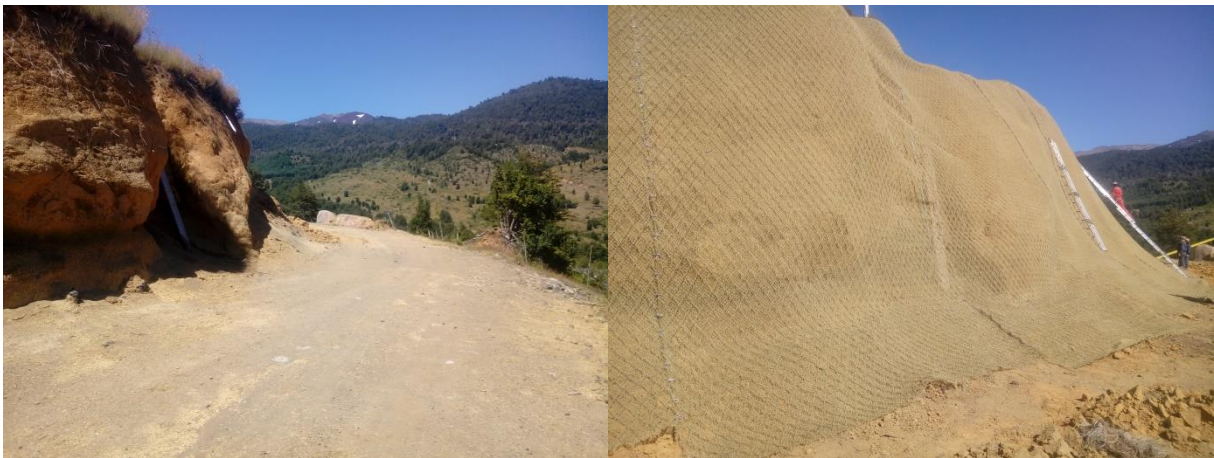
Mallas instaladas en Aducción Carilafquen con Mallas Greenax pk 600 aprox Punto 9 UTM coordenadas 282.734, 5.690.743
