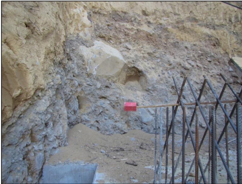
Fotografía 5-2: Excavación de ladera en materiales no consolidados de origen glacial, vista A (depósitos morrénicos).
