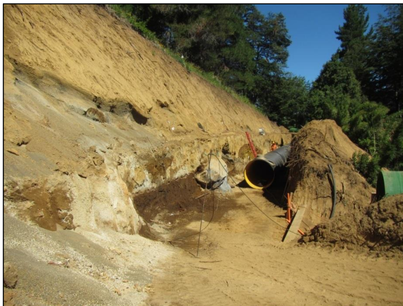
Fotografía 3-2: Derrumbe talud de excavación en quebrada N°3, central Malalcahuello, vista B.
