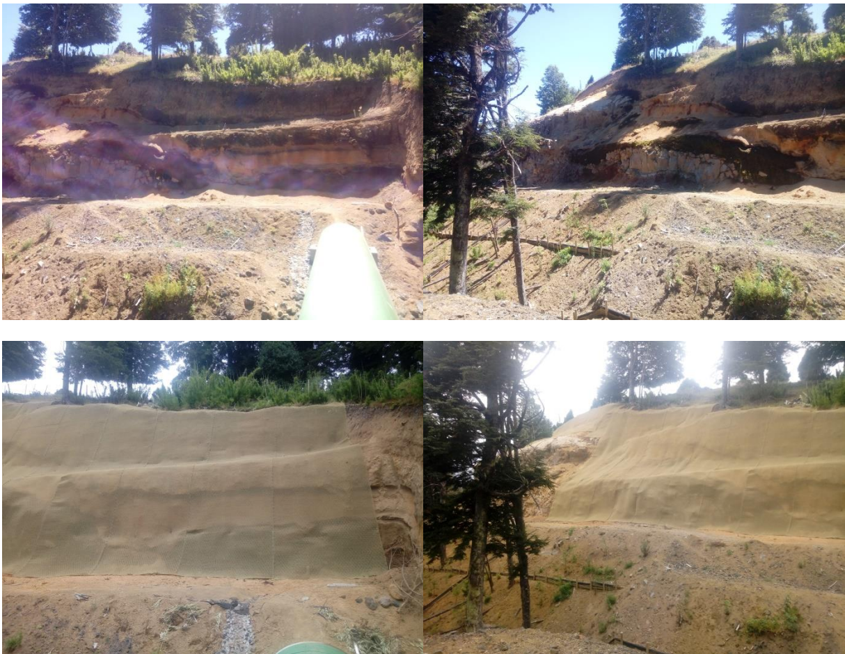
Mallas instaladas en Aducción Carilafquen Condición Inicial y Condición con Mallas Greenax pk 200 al pk 600 Punto 5 UTM coordenadas 283.078, 5.690.600
