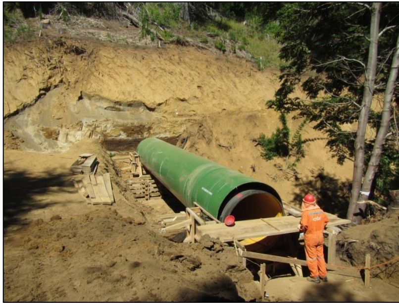
Fotografía 3-1: Derrumbe talud de excavación en quebrada N°3, central Malalcahuello, vista A.
