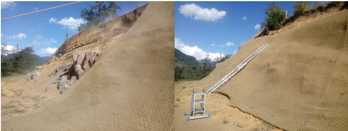
Instalación de Malla Greenax en Aducción Malalcahuello pk 1250 al pk 1450 aproximado. (Punto 3 UTM coordenadas 283.050, 5.692.297)
