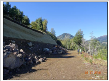
Imagen N° 4: sector de tubería de aducción de Carilaquén cercano a la chimenea de equilibrio, donde se observa acopio de rocas a los pies del talud.
