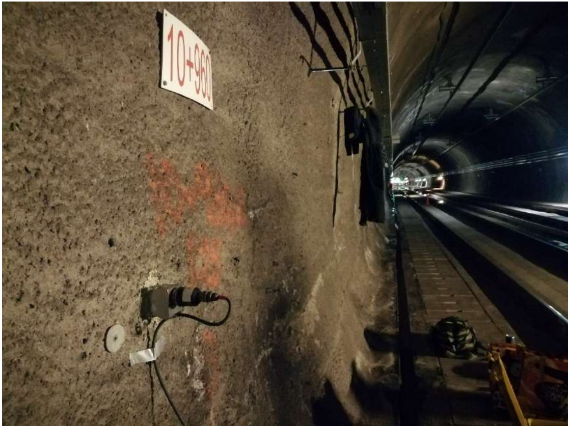
Ilustración 9: Anclaje de acelerómetro con cubo de acero, anclado al muro y unión magnética
