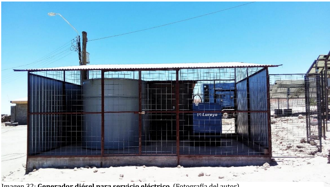
Imagen 32: Generador diésel para servicio eléctrico. (Fotografía del autor).
