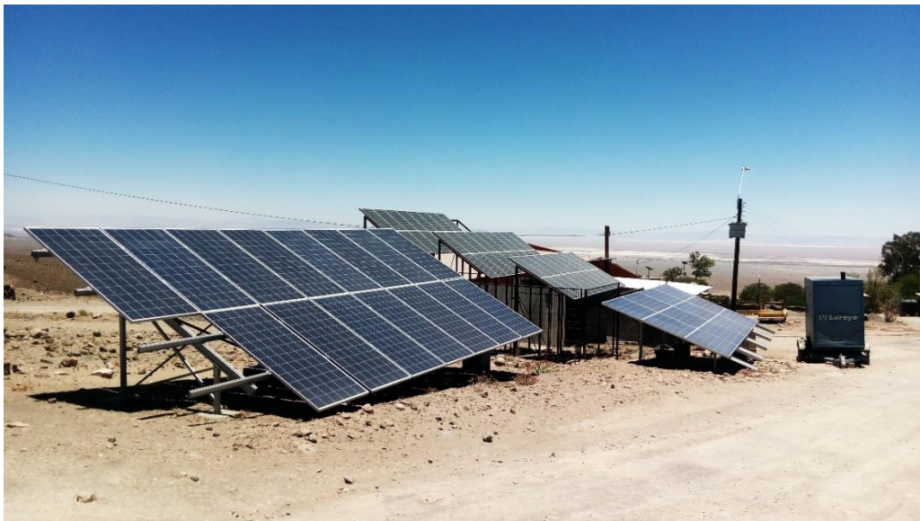
Imagen 34: Paneles solares. (Fotografía del autor).
