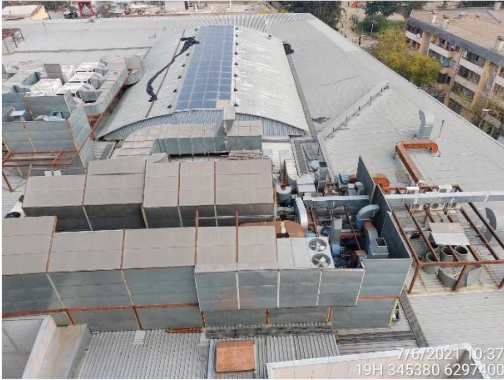
Equipos de clima
