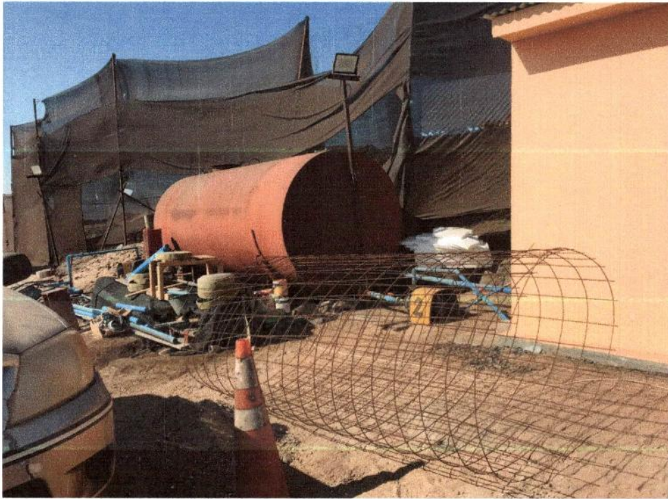
Imagen 28: Foto de inspección faena 10.06.2021 – Sección del cierre sureste en mal estado
