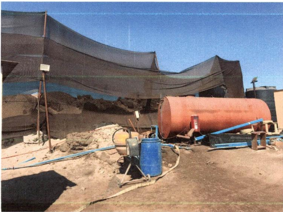
Imagen 29: Foto de inspección faena 10.06.2021 – Sección del cierre sureste en mal estado
