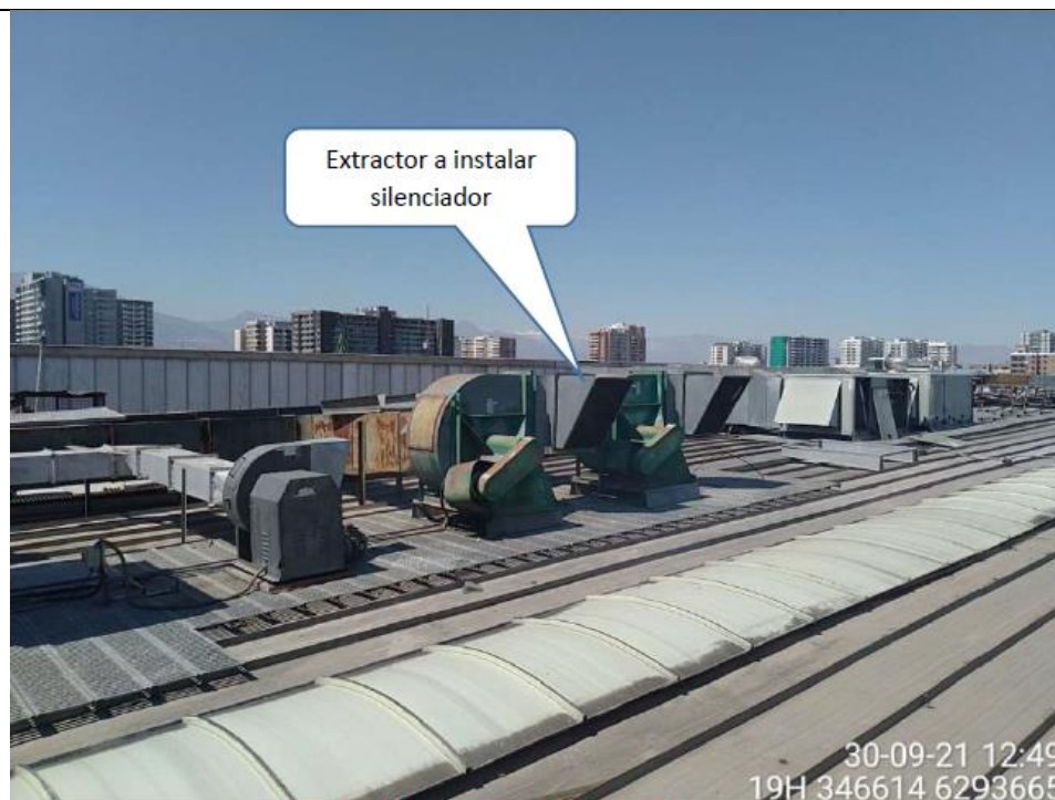
Fotografía de Extractor de Aire – Rincón Jumbo
