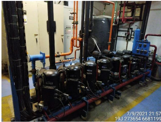
Sala de compresores
