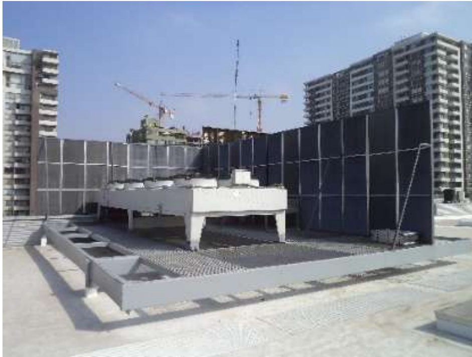
Imagen 4: referencia de barreras acústicas implementadas.
