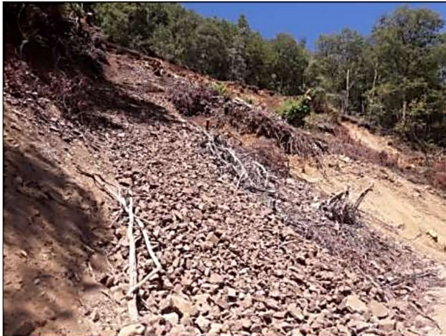
Figura 2-3. Vista del deslizamiento del Talud 2 Pk 1+190 a 1+230. Vista desde el camino del proyecto.
