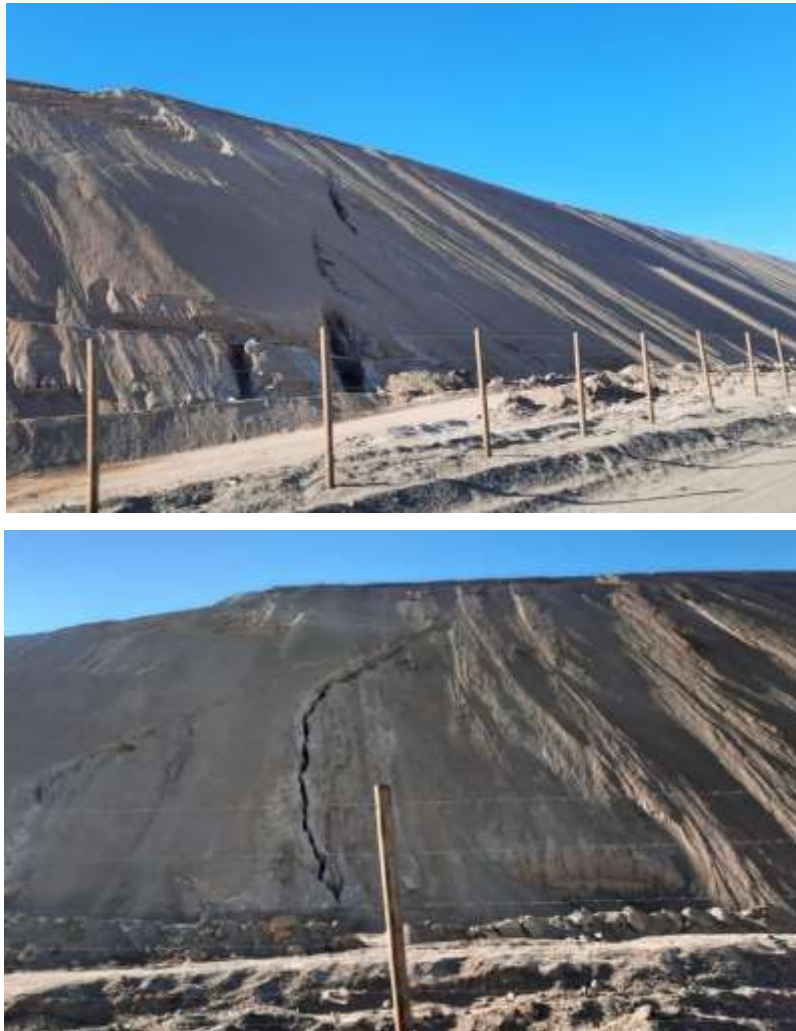
Figura 2: Vista Grieta en Muro de Tranque de Relaves Mantos Blancos
