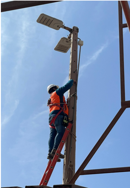
Instalacion según D.S43
