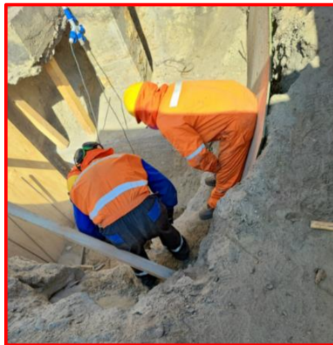
Fotografía N°1: Hallazgo de masa de hormigón externa a la fundación F1.
