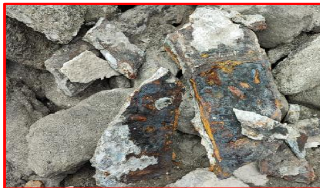
Fotografía N°4: Hallazgo de carbonatación de fundación F1
