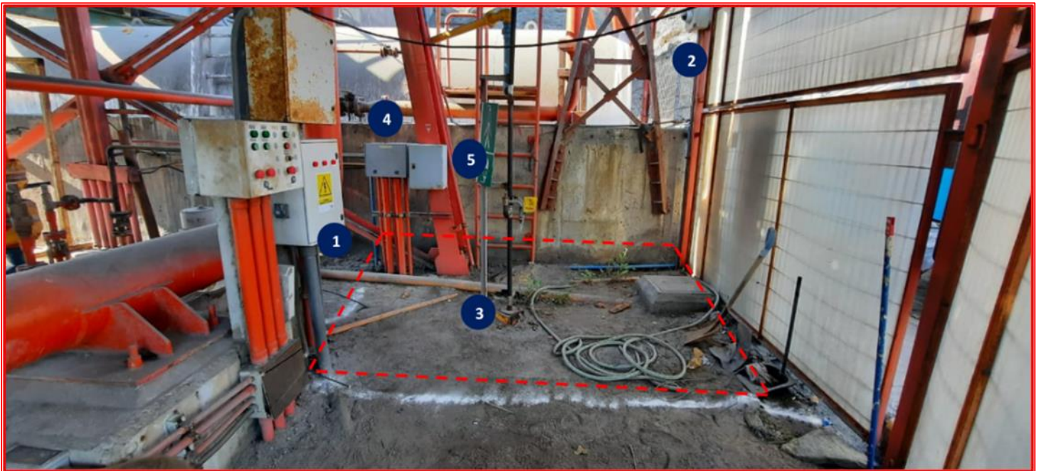
Fotografía N°5: Interferencia en sala de bombas de ácido sector playa, Sitio N°1.
