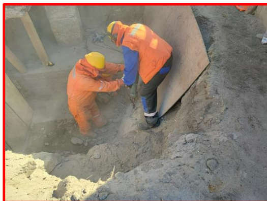
Fotografía N°2: Inicio de remoción de masa de hormigón externa encontrada.
