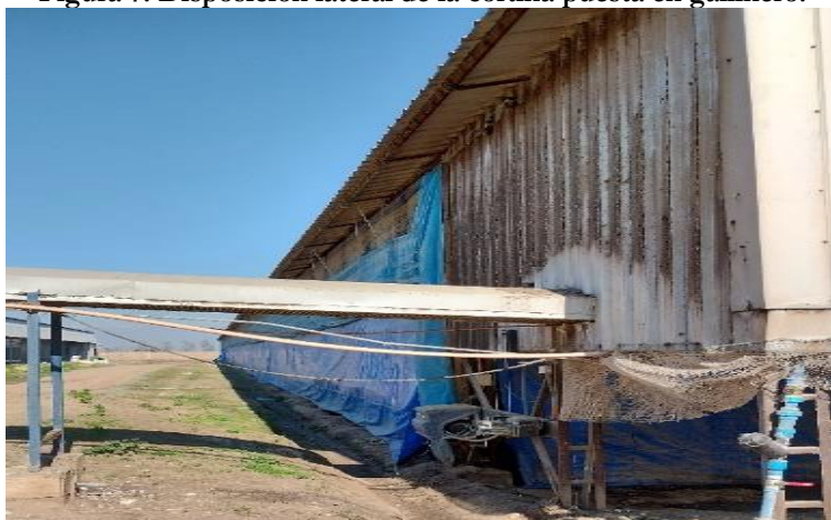
Figura 7. Disposición lateral de la cortina puesta en gallinero.
