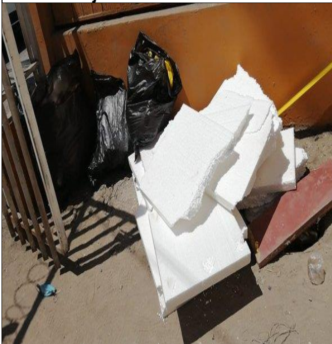
Escombros producto del trabajo
