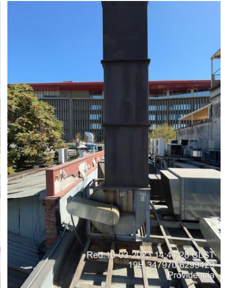
Ventilador centrífugo Patio Bellavista
