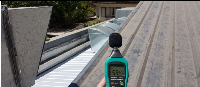
Se realizó cierre y aislación del patio técnico, medida máxima obtenida 59,4dB.
