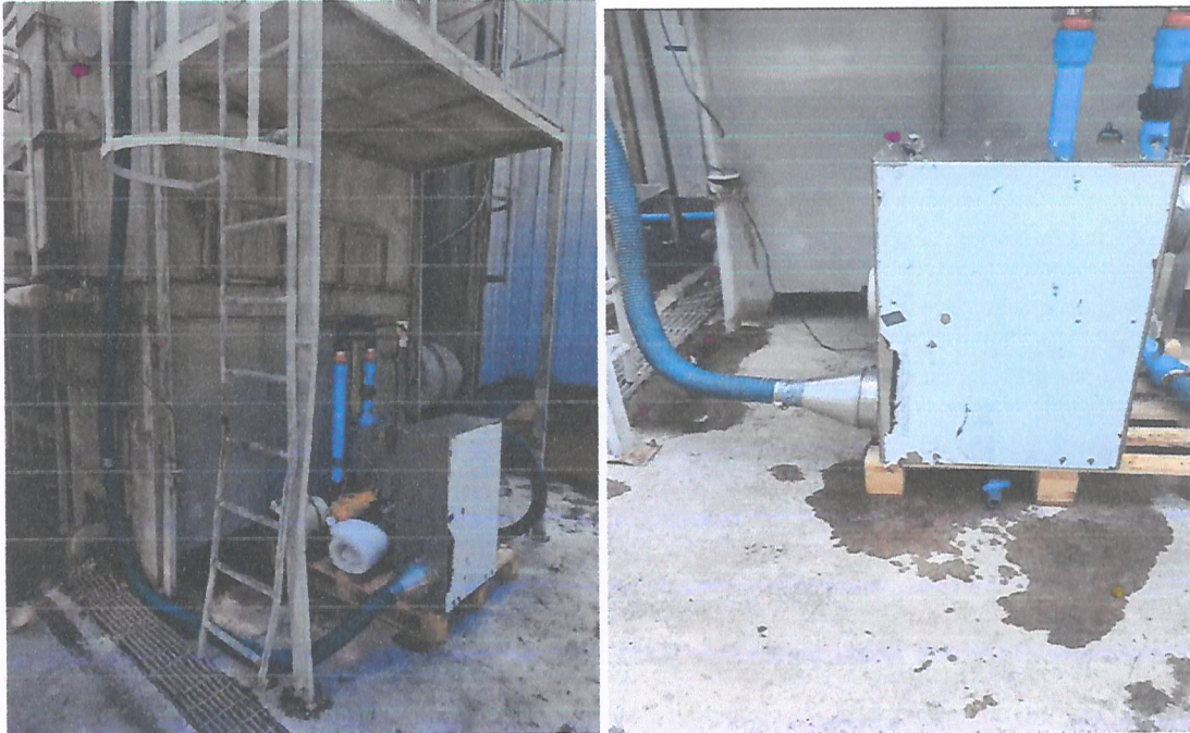
Ilustración 8: Modificación de posición de manguera inicial vs final
