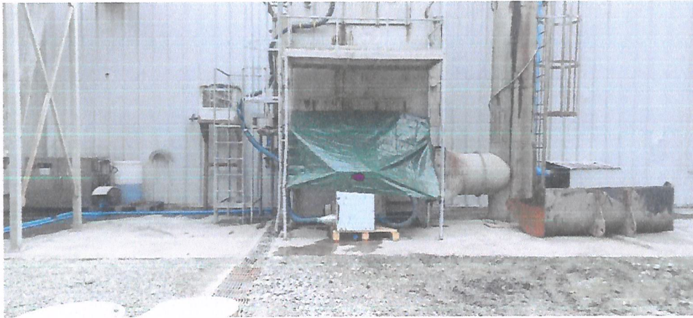
Ilustración 9: Instalación con cobertura de lluvia
