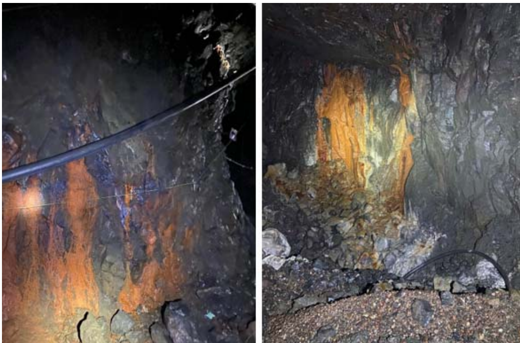
Figura 9 – Infiltraciones de agua Galerías de Producción Sector Gaby
